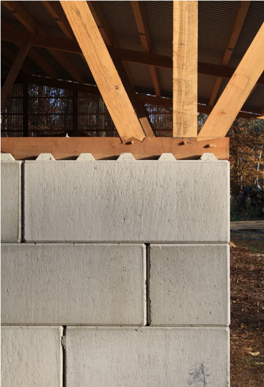
Für das witterungsgeschützte Lagern von Hackschnitzeln brauchten die Forstbetriebe Rittergut Todtenkopf eine geräumige und luftige Halle. Foto: Florian Hallmann
